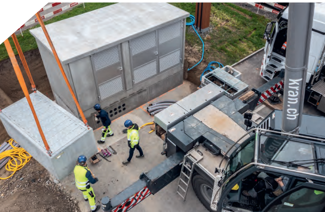
Trafo für Schnellladestation E-Mobilität
