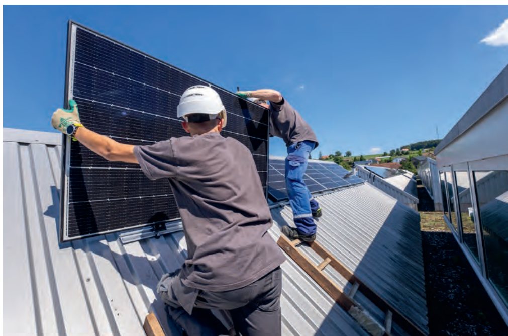
Photovoltaikanlage Orientierungsschule Region Murten
